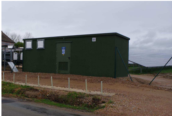
Figure 83 : Exemple de poste de livraison (source : Arvro Energies, 2023)
